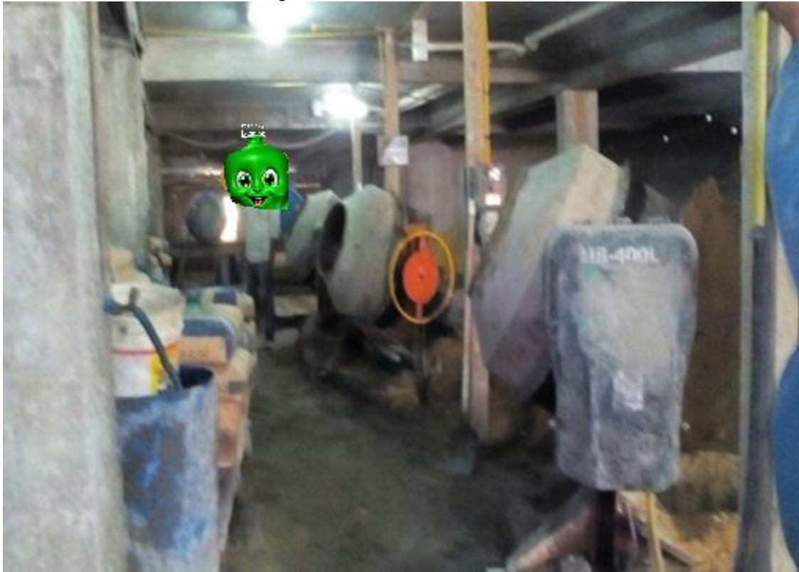
Figura 18 – Setor de betoneiras 2
