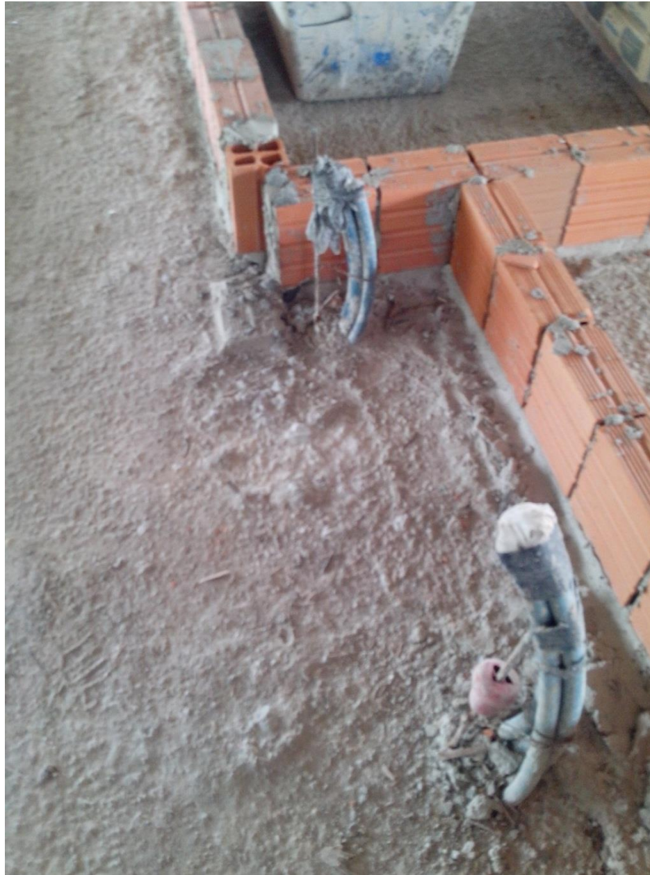
Figura 14 – Vergalhões descumprindo a norma
