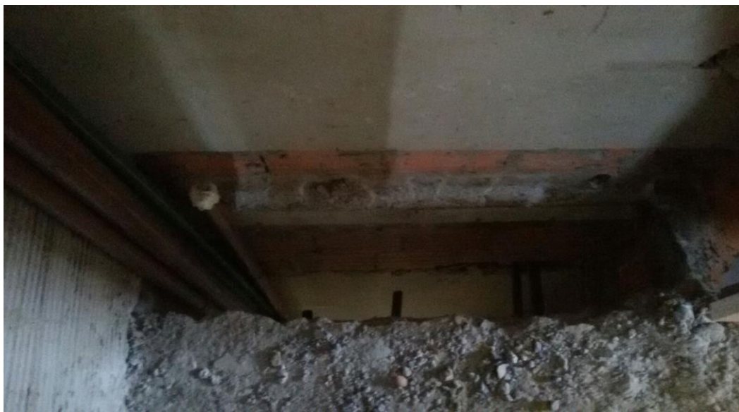
Figura 16 – Buracos causados pela hidráulica 2
