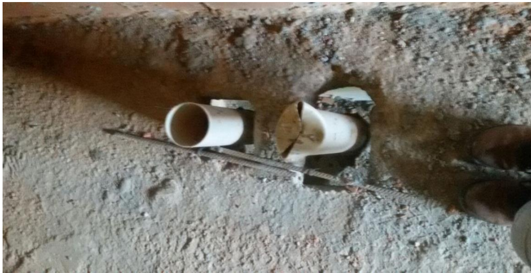
Figura 15 – Buracos causados pela hidráulica
