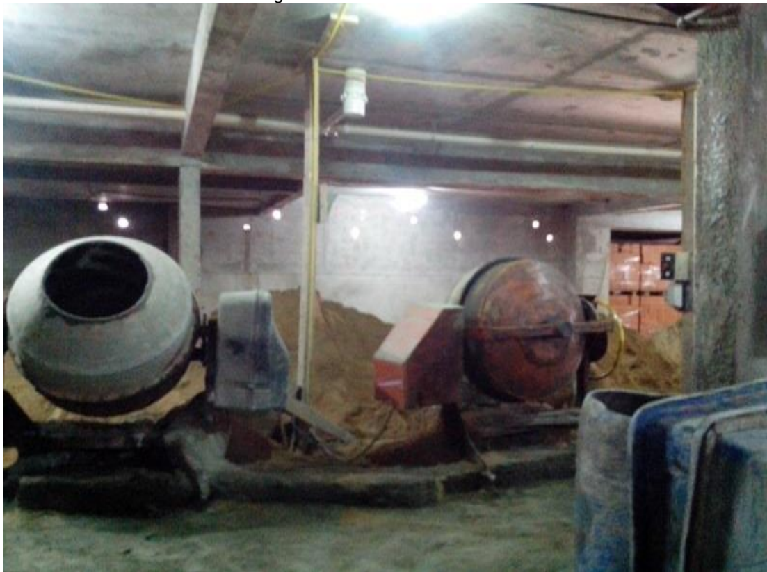
Figura 17– Setor de betoneiras
