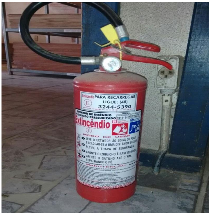
Figura 10 - Extintor De Incêndio Em Local Inadequado
