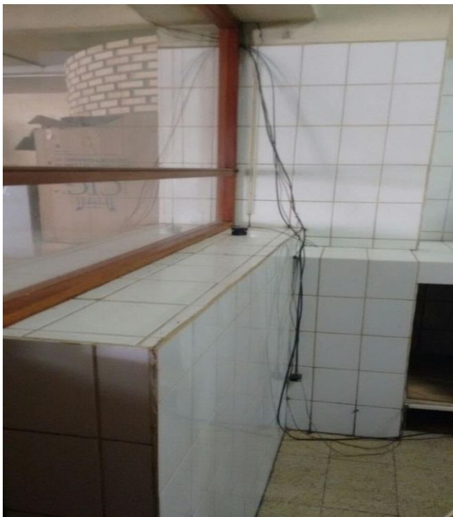
Figura 13 - Fios De Eletricidade De Fácil Acesso.
